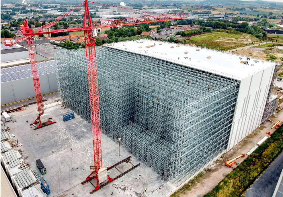
Ryc. 54. Przykład realizacji magazynu regałowego, wysokiego składowania o samonośnej konstrukcji.
