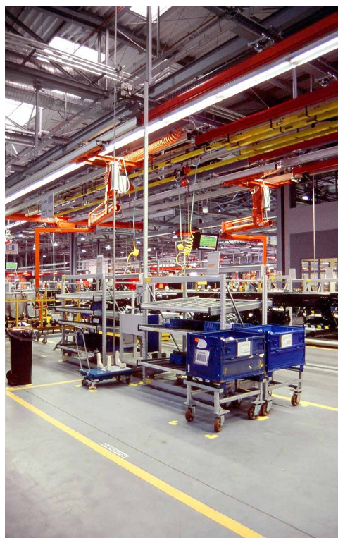
Ryc. 34. Zasilanie stanowisk pracy z instalacji prowadzonych pod stropem w hali montowni samochodów ciężarowych firmy MAN (MAN Trucks Sp. z o.o.) w Niepołomicach pod Krakowem.
