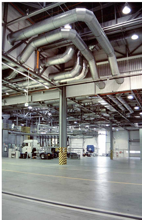
Ryc. 33. Strop technologiczny i podłoga służąca tylko do komunikacji technologicznej i zaopatrzeniowej w hali montowni samochodów ciężarowych firmy MAN (MAN Trucks Sp. z o.o.) w Niepołomicach pod Krakowem.
