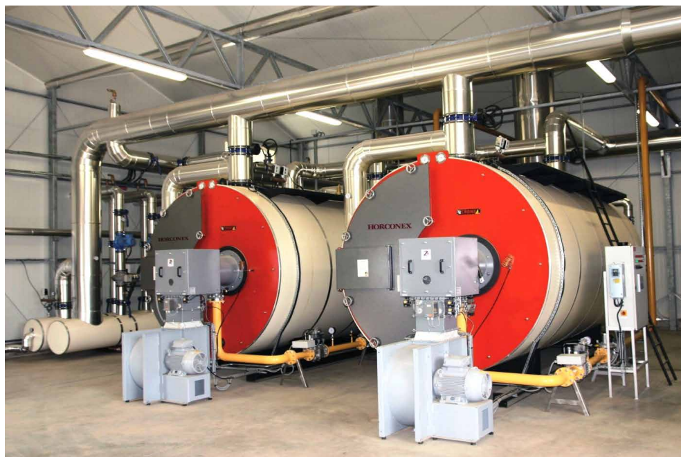
Ryc. 61. Instalacja nowoczesnej kotłowni przemysłowej wytwarzającej gorącą parę na potrzeby technologiczne, opalanej gazem, holenderskiej firmy Horconex.
